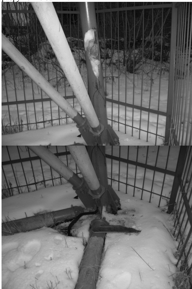
Рис. 1 Повреждение опорной ноги башни
